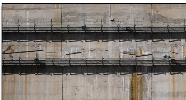
Figura 4 – Orto-imagem de alta resolução do paramento jusante da barragem do Cabril, com uma resolução de 3 milímetros
