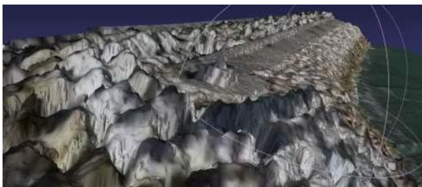
Figura 5 – Ortomosaico sobre o MDS. No centro, ao longo do molhe, a superestrutura em betão. Na extremidade mais próxima, no centro de uma zona circular, o farolete instalado sobre uma base em betão
